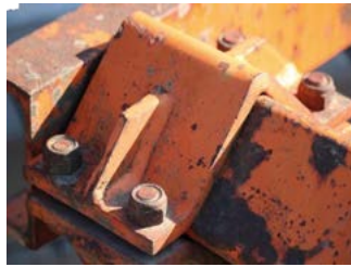
Corrosão em frestas
